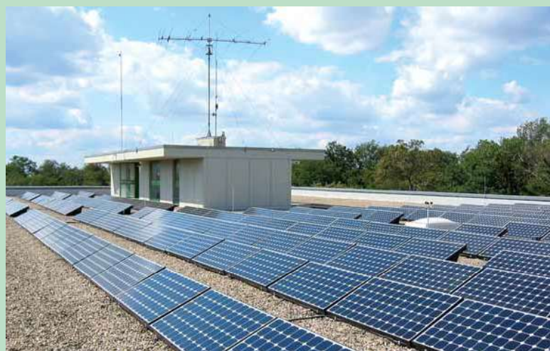
Photovoltaik-Anlage bei DLØIF
